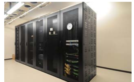
コンテナ型データセンターに収められているサーバ
