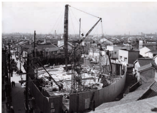
二代目通天閣の建設当時、タワークレーンはまだなかった。中央に工用の鉄塔を立て、ワイヤーを張り滑車で資材を引っ張り上げるガイデリックという起重機が使用された
