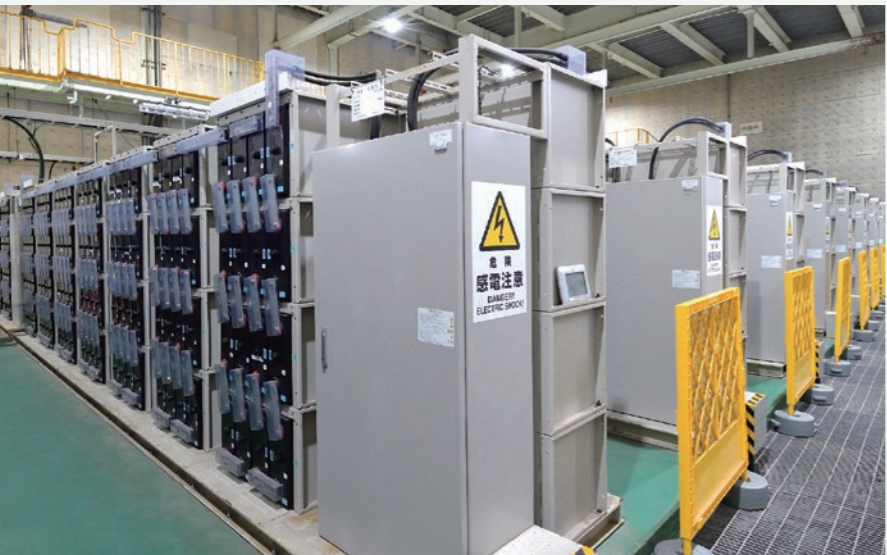
再エネ普及に向け、今後ますます重要度が高まる蓄電池装置
