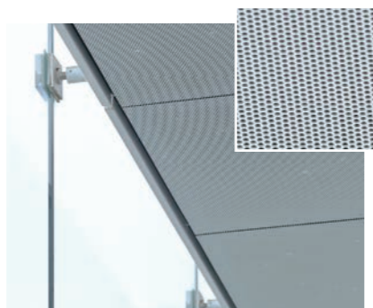
パンチングメタルの天井。小さな穴を通して換気を行い駅舎と自由通路の快適な環境を保っている。
