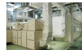
ドライクリーンルーム
