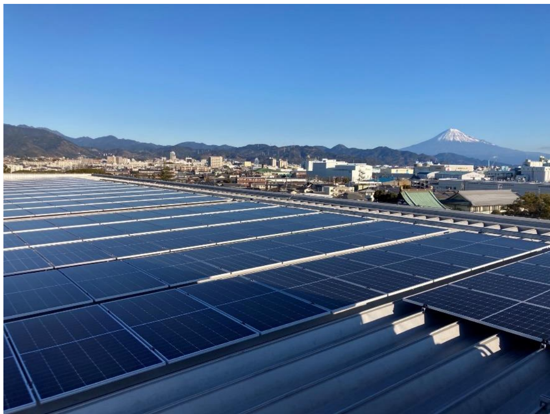
清水事業所（静岡県静岡市）に設置した太陽光パネル
