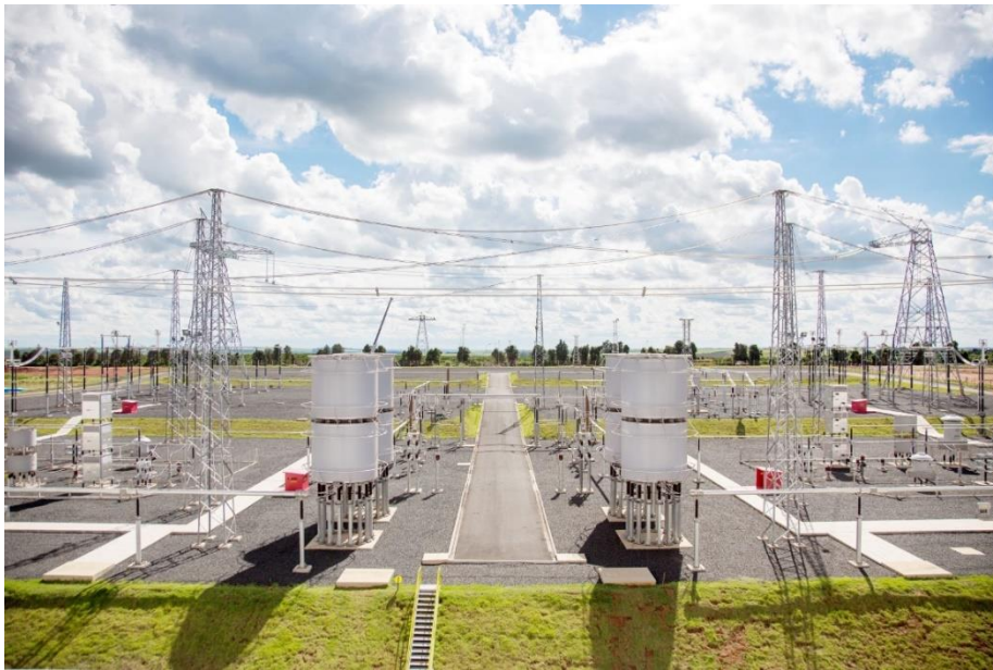
リオ・マデ이라 HVDC システム
