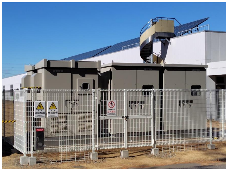
習志野事業所に実装したグリッド・フォーミング・インバータの設備
