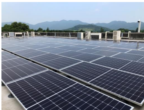
日立 GLS 栃木事業所の 開発建屋屋上に並べられた太陽光パネル
