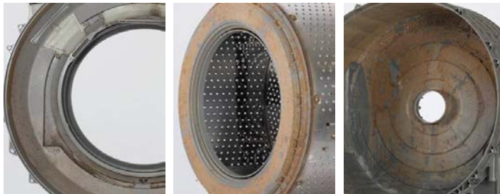
外槽前カバーの裏側の汚れ
