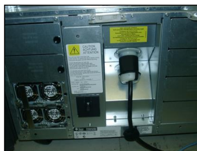
System Power Circuit Breaker (ドライブ拡張モジュール側)
