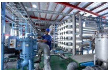
海水淡水化装置
