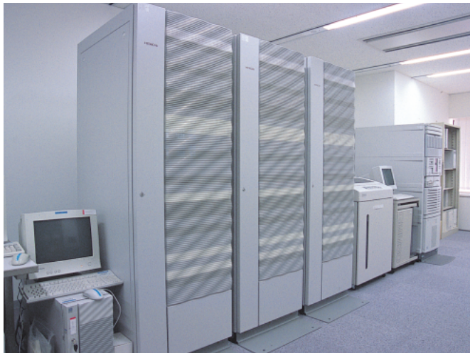
GEMPLANETサーバ(HA8000)、DWHサーバ(H9000V)、Metaframeサーバ(HA8000)などを納めたサーバラック群
