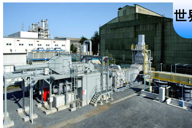
3MW A-HATシステム検証機 (効率はコンバインドサイクルと同等)
