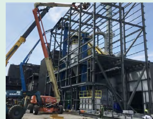
砂の再生処理装置
