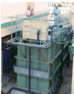
ドバイ市内レイバーキャンプ向け「ペルセウス」設備。約1,500人の生活排水を処理している
