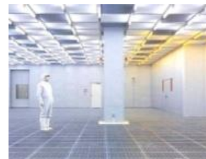
クリーンルーム設備
