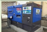
水素混焼 発電機*
